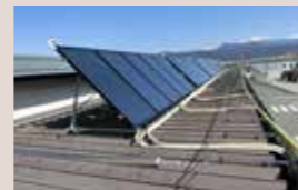
駒ヶ根工場に設置された 太陽熱温水器パネル
