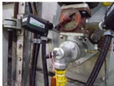
LNGバーナー
