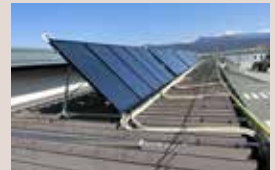
駒ヶ根工場に設置された太陽熱温水器パネル
