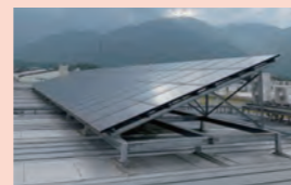
駒ヶ根工場に設置された太陽光パネル
